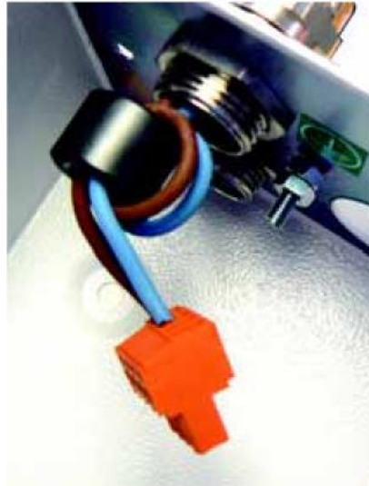
Figura 8: Circuitos de los cables de conexión del relé alrededor de una ferrita de supresión
